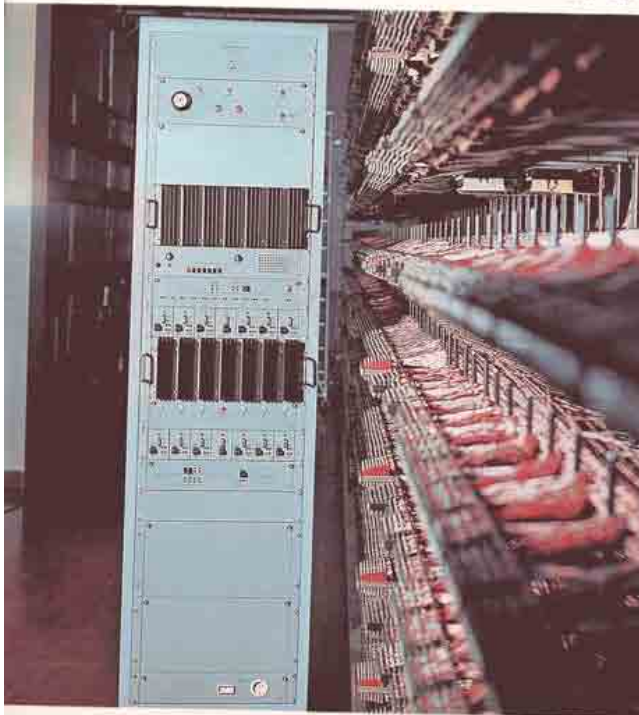
Apparecchiatura di amplificazione a canali separati per la trasmissione sulle linee di utente dei programmi di filodiffusione.
