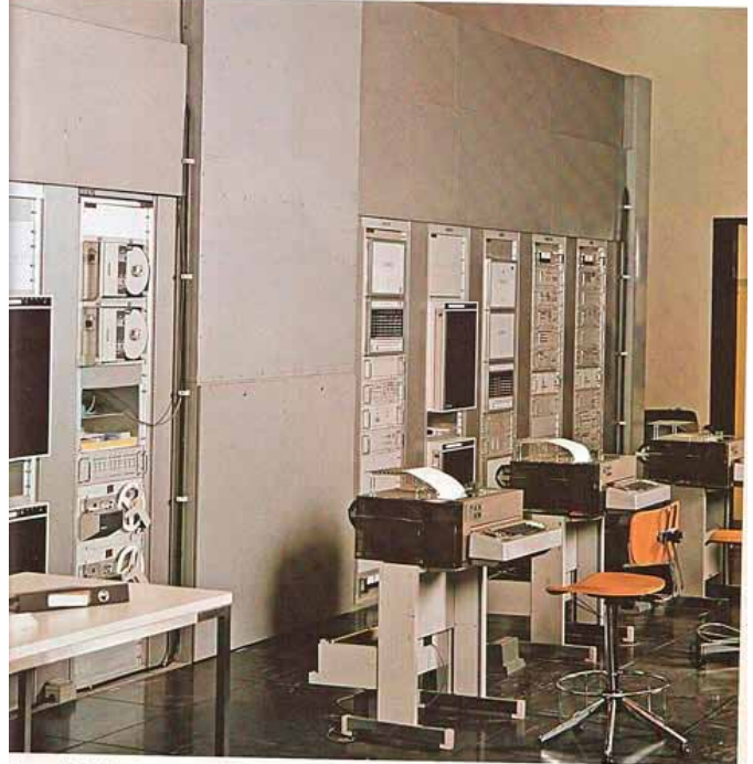
Una parte parziale dell'impianto CATTO (Contabilità Automatica del Traffico Telefonico da Operatore) (art. a p. 235)
