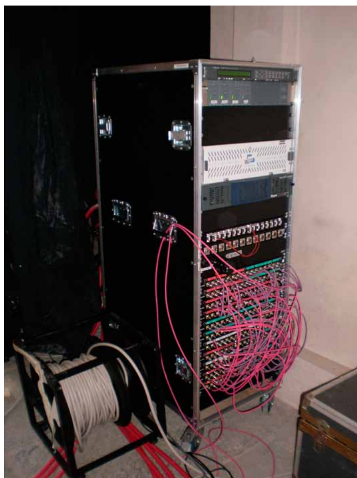
Fig. 2 - Flight case "trasmissione": qui si accentrano tutti i segnali video provenienti dalle telecamere, sia tramite cavo coassiale sia in fibra ottica, i quali vengono sincronizzati e distribuiti ai vari componenti della regia (mixer, banco registrazione, sistema di misura e taratura).
