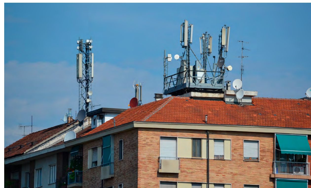
Fig. 1 - Impianti riceventi DTT in prossimità di una Base Station LTE.
