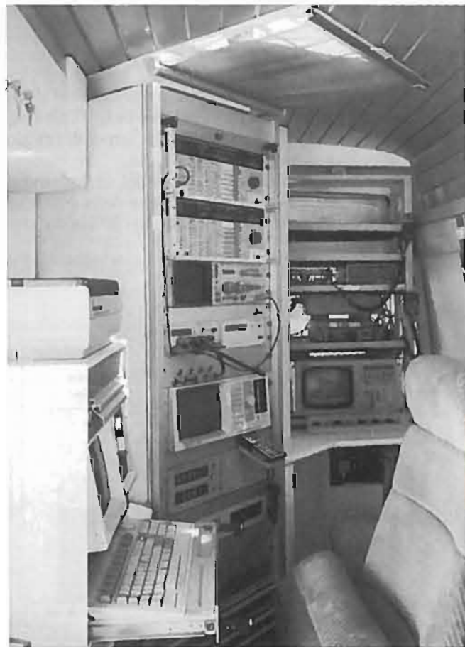
Fig. 21 — Vista delle apparecchiature installate all'interno dell'automezzo per radio misure.
