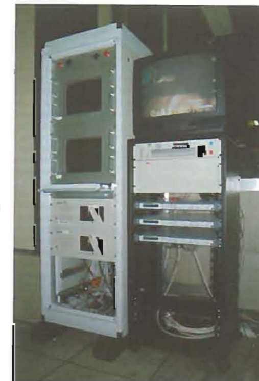
Fig. 12 - Sistema d'acquisizione in servizio. A sinistra: stazione d'acquisizione ridondata completa di modulo per la distribuzione del segnale orario su RS232. A destra: insieme di demodulatori TV e matrici di distribuzione. Sul rack, televisore di monitoraggio.
